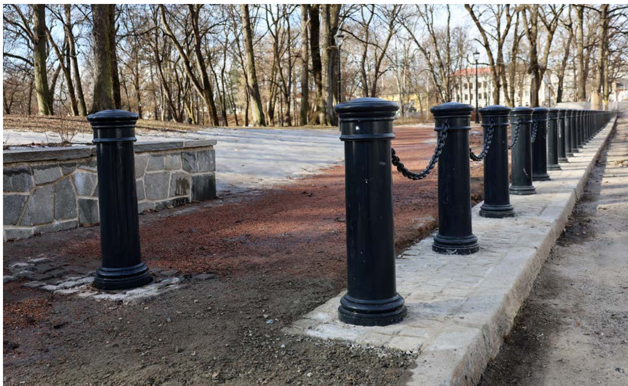
Statiske pullerter er på plass, blant annet langs Wergelandsveien.
